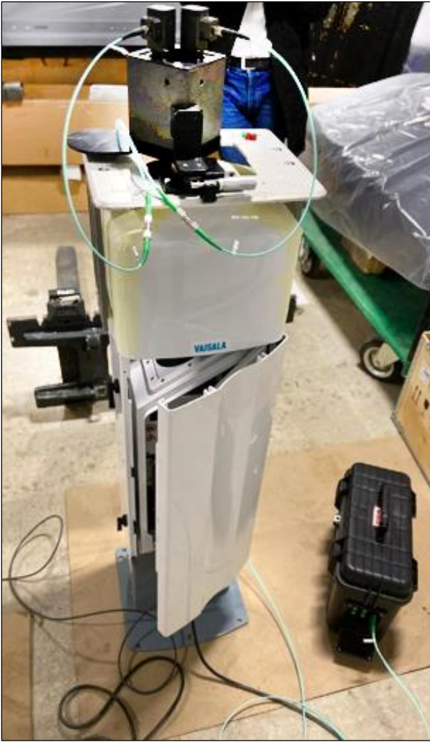
Рис.1 ВОЛЗ-1, установленный на прибор измерения высоты облаков.
